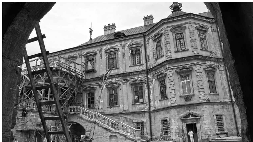
Замкове подвір'я. Кінця ремонтів не видно, а коштів бракує.
